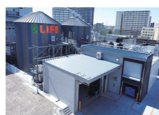
バイオガス発電を導入いただいた、(株)ライフコーポレーションの総菜工場
